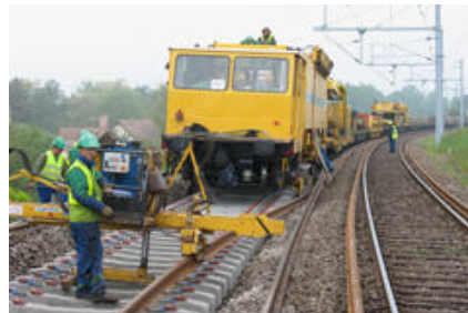
Longs Rails soudés sur traverses béton
